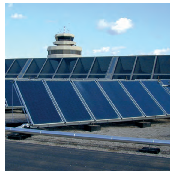
Paneles solares en el Aeropuerto de Palma de Mallorca.
