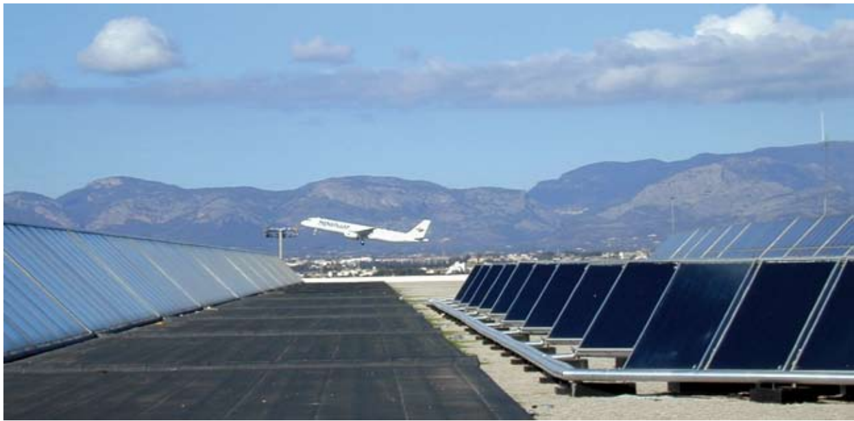
Paneles solares en el Aeropuerto de Palma de Mallorca. / Solar panels at Palma de Mallorca Airport.
