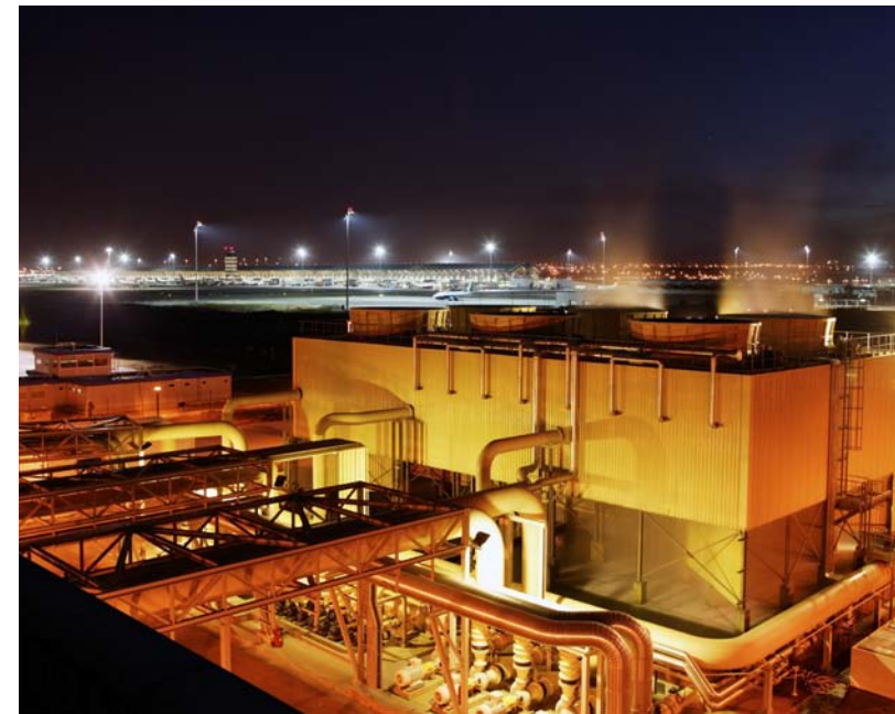
Planta de cogeneración de Madrid-Barajas
