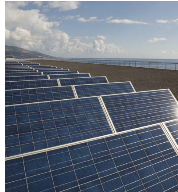
Paneles Solares en el Aeropuerto de la Palma
