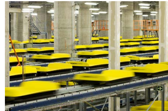
Sistema SATE del Aeropuerto de Madrid-Barajas
