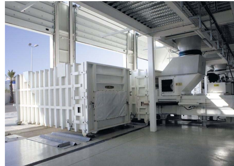
Sistema neumático de recogida de residuos. Aeropuerto de Alicante
