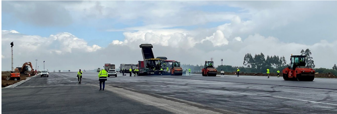
Pista del Aeropuerto de Santiago-Rosalía de Castro durante las obras de regeneración del pavimento. © Aena
