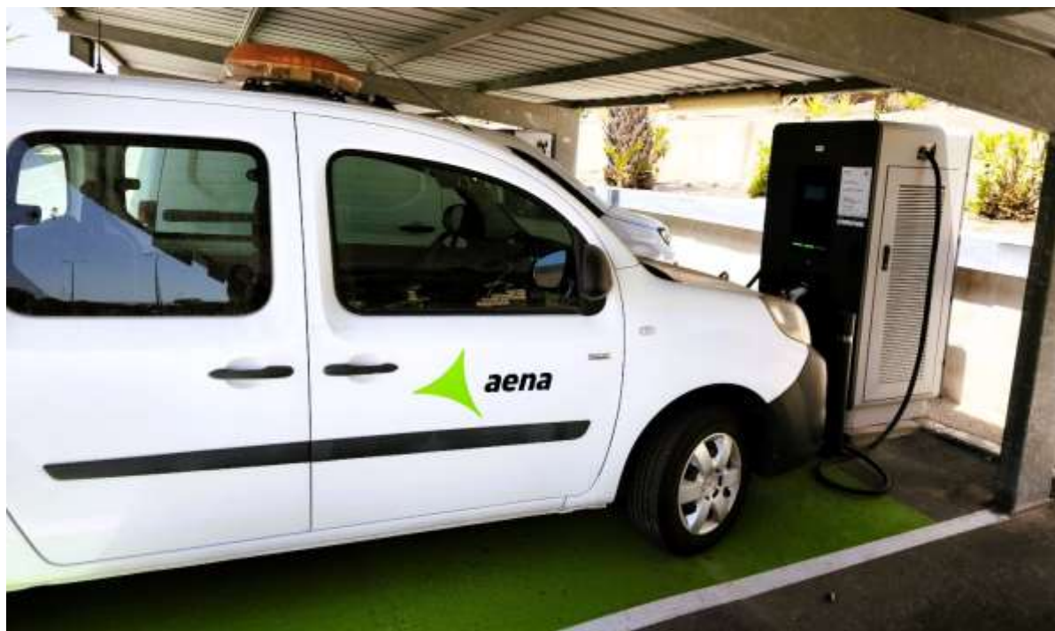
Uno de los nuevo 37 puntos de recarga de vehículos eléctricos del Aeropuerto de Almería. © Aena.
