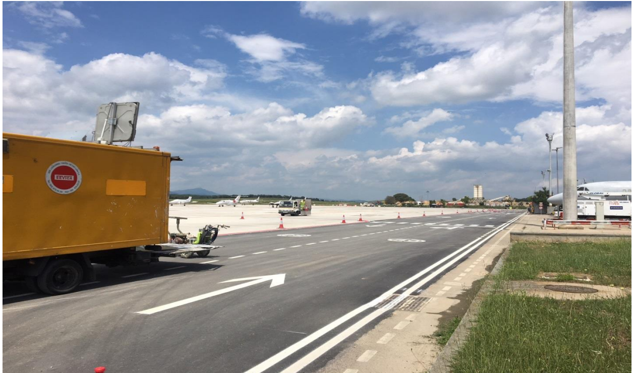
El pavimento asfáltico del vial del SSEI
